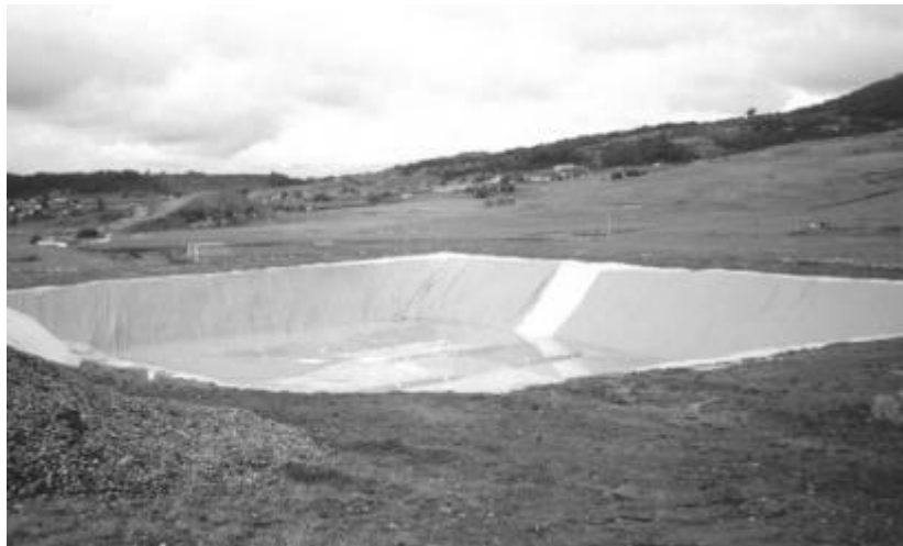
Figura 3. Captación de agua en ladera
